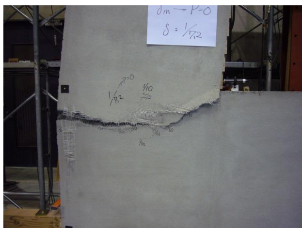
写真 3.2.39 No.6 左下側破断状況
