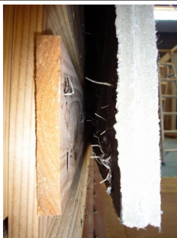
写真 3.3.21 モルタルの浮き
