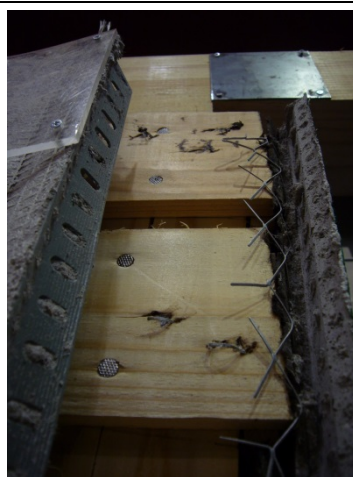
写真 3.3.37 釘抜け/ステープル抜け状況
