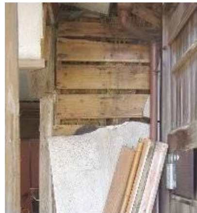
写真 2.1.9 雨樋閉塞による漏水で筋かいが腐朽し、変形が大きくなり脱落したラスモルタル外壁の例(西本町)
