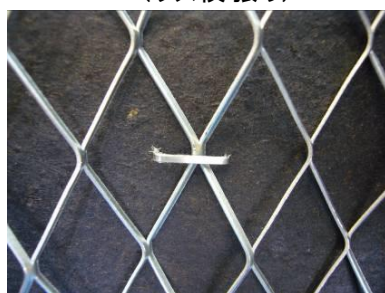
写真 3.3.12 ラス縦張りのステープル
