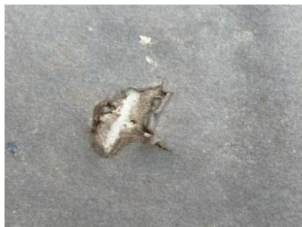
写真 2.1.26 平ラスの破断状況(名取市)
