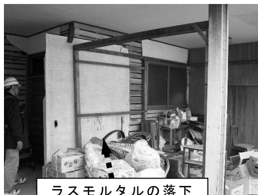
写真 2.1.2 ラスモルタルの落下
