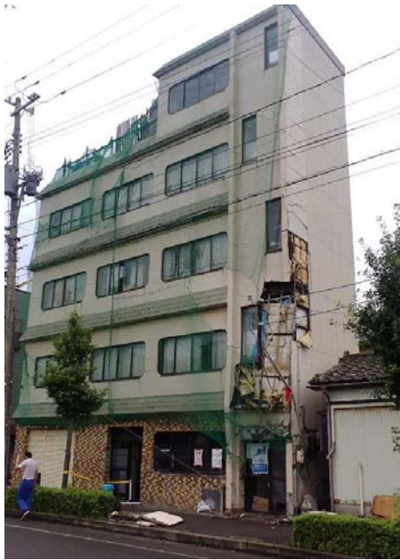
写真 2.1.10 外壁下地腐食によるリブラスモルタル外壁の脱落(小倉町)築 30 年以上
