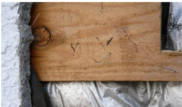
写真 2.1.28 ステープルが抜けた状況
