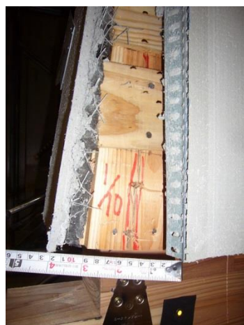
写真 3.3.25 釘抜け/ステーブル抜け状況
