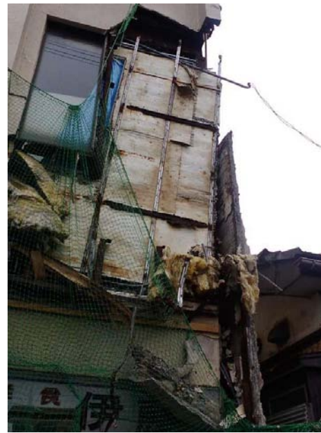
写真 2.1.11 写真 2.1.10 の拡大(内壁および断熱材の鋼製下地周りに結露跡が見られる)
