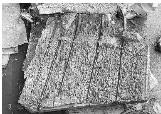
写真 2.1.1 リプラス結束線腐食
