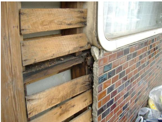
写真 2.1.8 サッシ取り合い部からの漏水による木下地およびステープル・ラスの腐食によるラスモルタル外壁のはく落例
