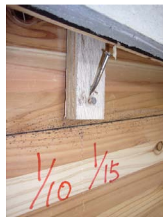
写真 3.3.35 N65 の抜け・変形
