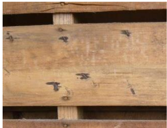
写真 2.1.24 ラス下地板にステープルが残っている状況(名取市)
