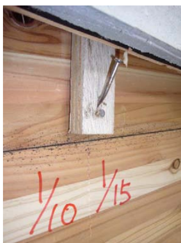
写真 3.3.46 N65 の抜け・変形
