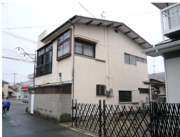
写真 2.1.20 開口部のひび割れのみラスモルタル外壁の例(名取市)
