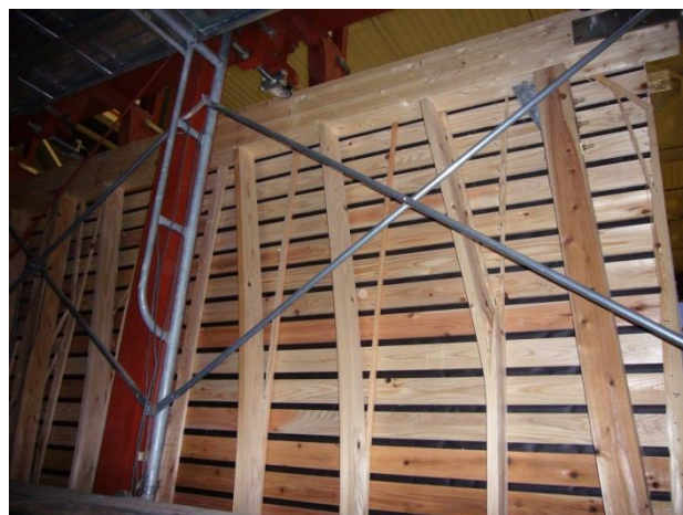
写真 3.2.19 No.0-2 胴縁の割裂状況
