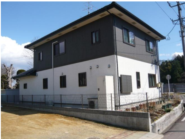
写真 2.1.21 損傷が認められなかったラスモルタル外壁の例(白石市)
