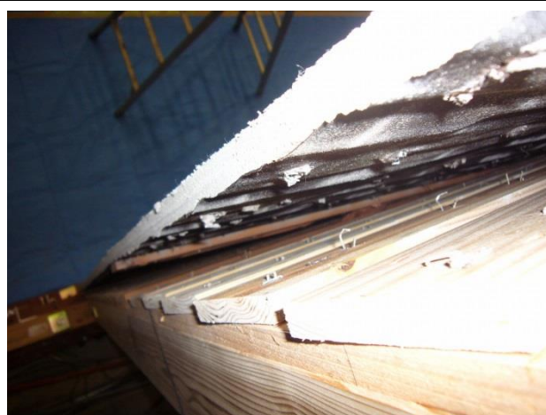
写真 3.2.21 No.1 モルタル剥離状況
