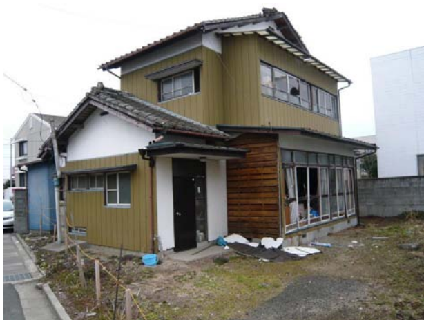
写真 2.1.23 ラスモルタル外壁が部分的に落下した例(名取市)
