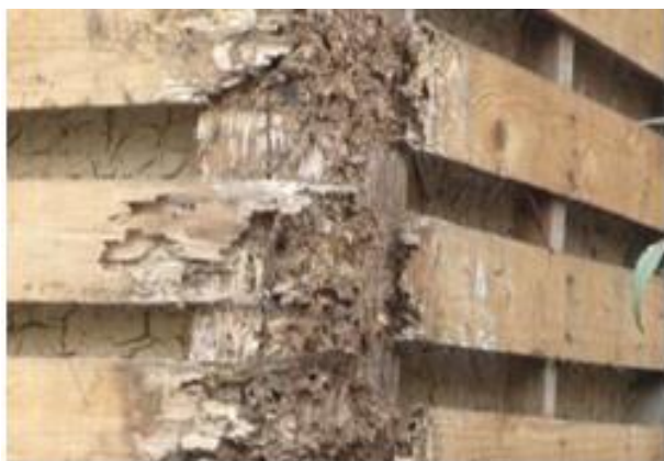
写真 2.1.29 生物劣化による柱部分の腐朽(福島市)
