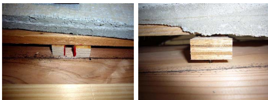
写真 3.3.45 通気胴縁の破壊状況(左:すぎ製材,右:合板)
