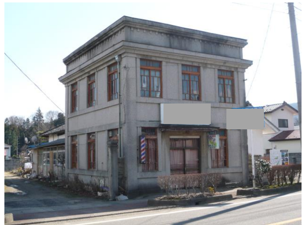
写真 2.1.22 損傷が認められなかったラスモルタル外壁の例(白石市)昭和8年竣工ワイヤラス
