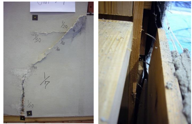
開口左下隅部の亀裂 / 窓台左端部腰壁浮き
