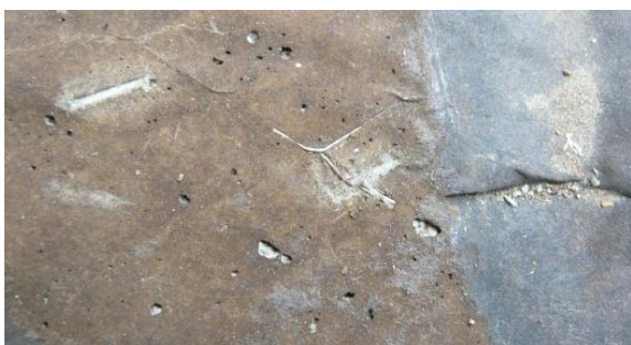
写真 2.1.25 線径の細い平ラスが使用されている(名取市)
