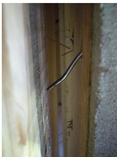
写真 3.3.32 合板釘抜け出し
