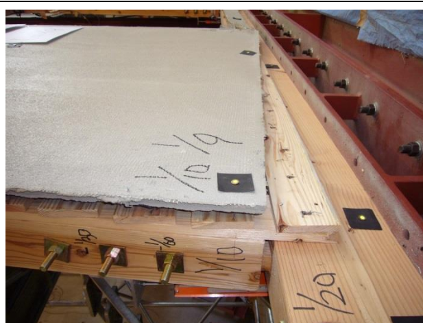
写真 3.2.23 No.2 壁脚部モルタル剥離状況
