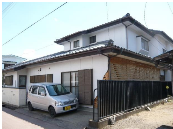
写真 2.1.27 ラスモルタル外壁が部分的に落下した例(白石市)
