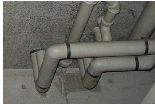
配管類の保温材
