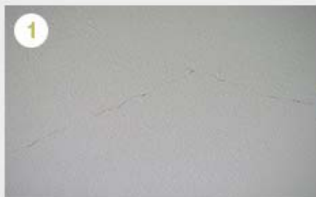
1 着工前、既存クラック
