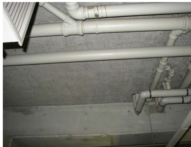
機械室の吹付材
